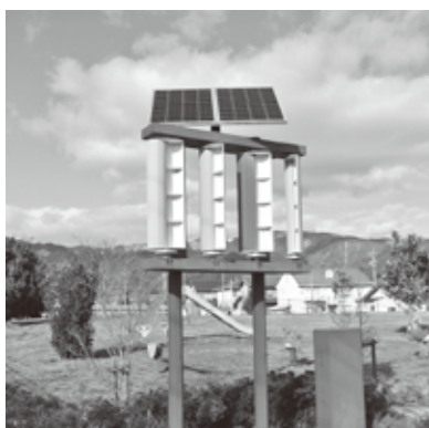
エコドームに設置されている 自然エネルギーを活用した発電装置
