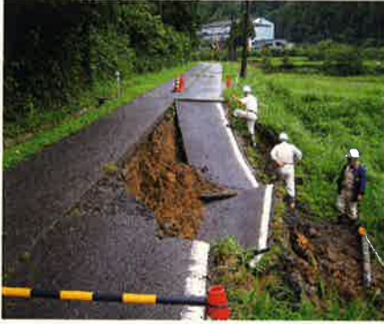
H20.9.2～3 ゲリラ豪雨 道路崩落状況
