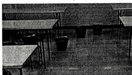
屋上防水機能の劣化による雨漏り
