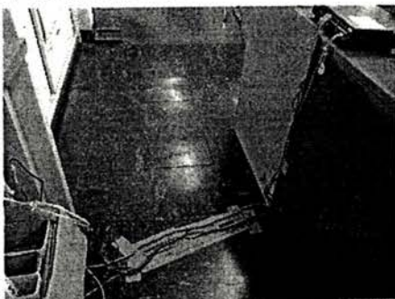
露出している LAN 配線の状況
