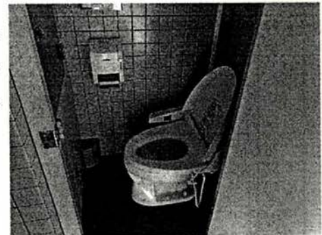
バリアフリーに対応できていないトイレ
