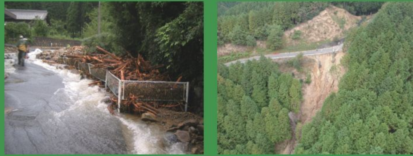
垂井町梅谷地内 平成20年 (台風被害)
