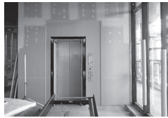
エレベーター
