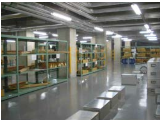
防災用備蓄スペース (小田原合同庁舎)
