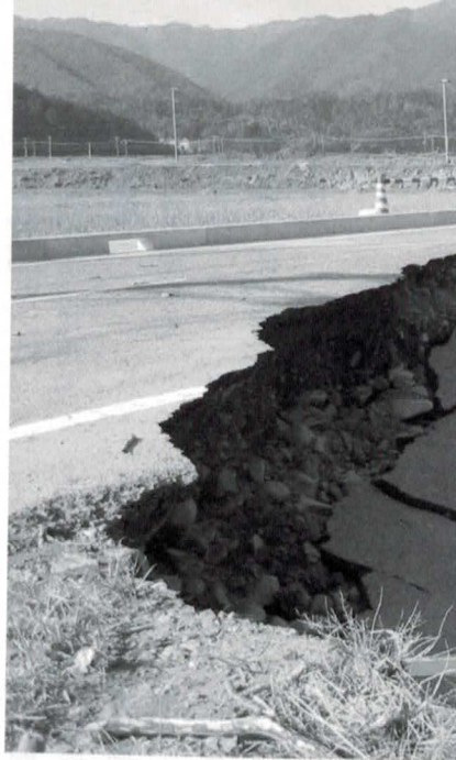
▶ 梅谷川の増水により崩壊した道路
