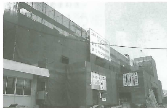
◀ 学校施設の充実を図るため 改築工事が進む不破中学校北舎
