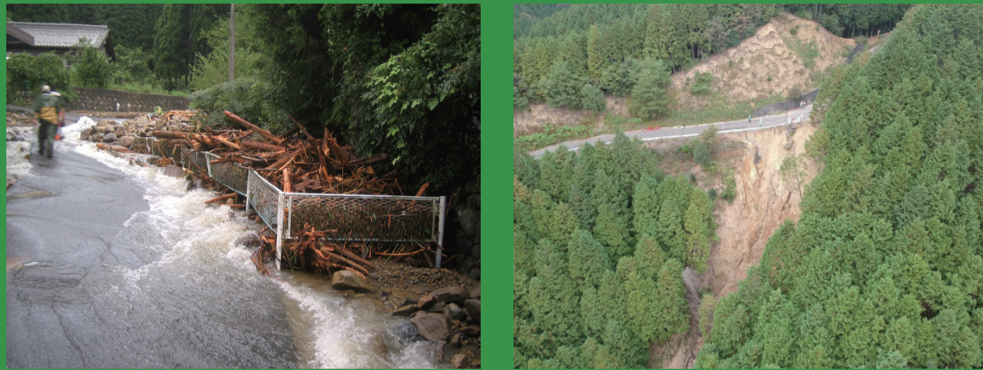
垂井町梅谷地内 平成20年 (台風被害)
